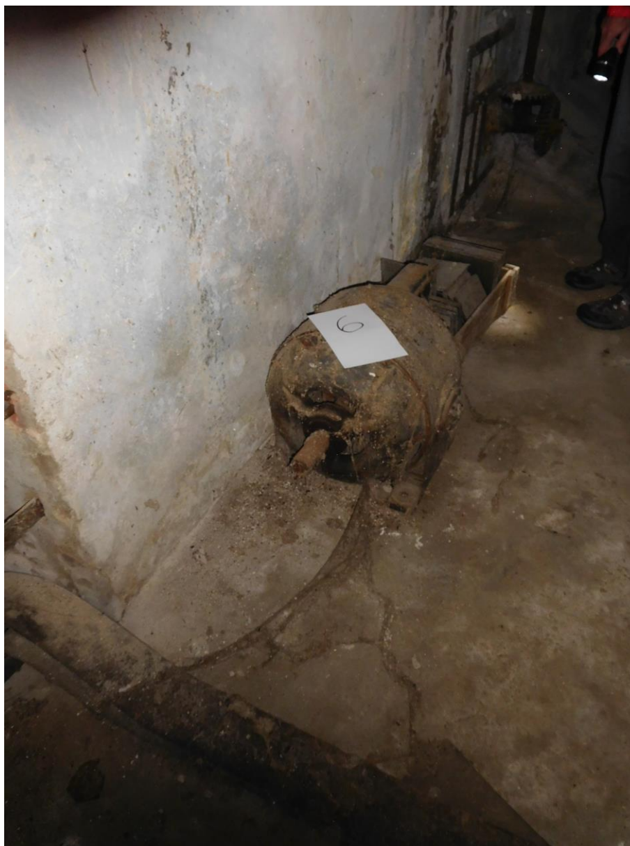
9. 1. NP - dynamo pri vstupe do strojovne (č. 6)
