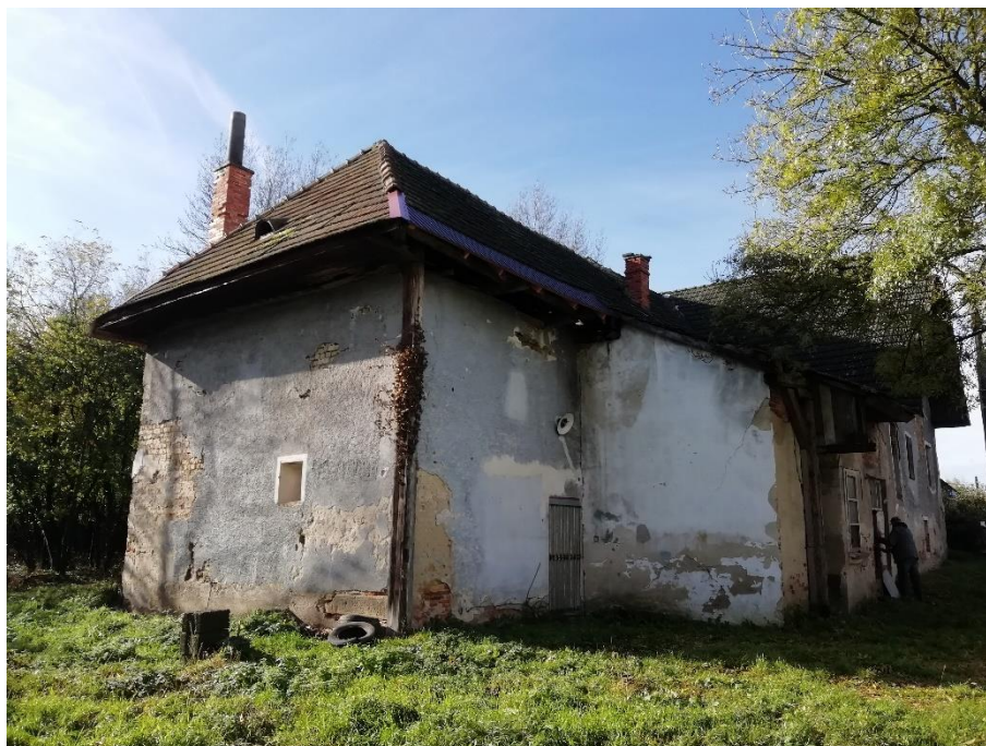
Pobedim, NKP Mlyn vodný, pohľad zo SV strany (S a V fasáda bytu mlynára a prístavby) 11/2023
