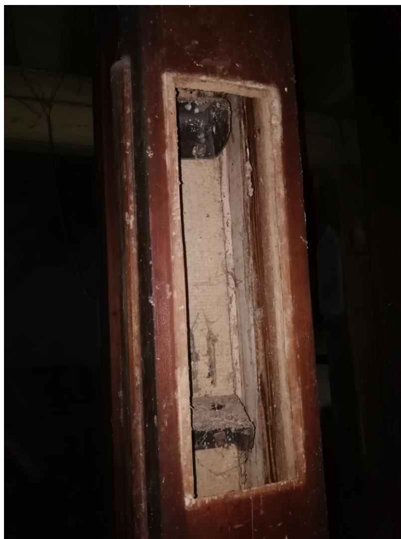
17. 2. NP - pohľad do korčkového výťahu
