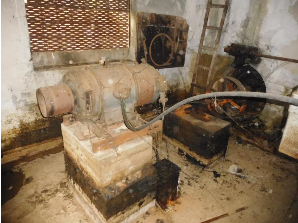
6. 1. NP - strojovňa- elektromotor (č. 3)
