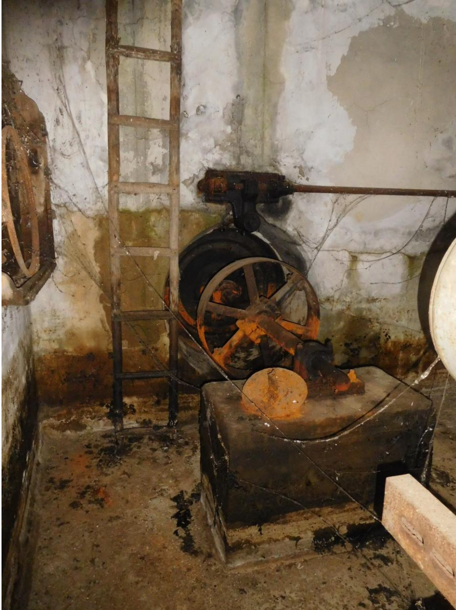
7. 1. NP - strojovňa- náhon na transmisiu (č. 4)
